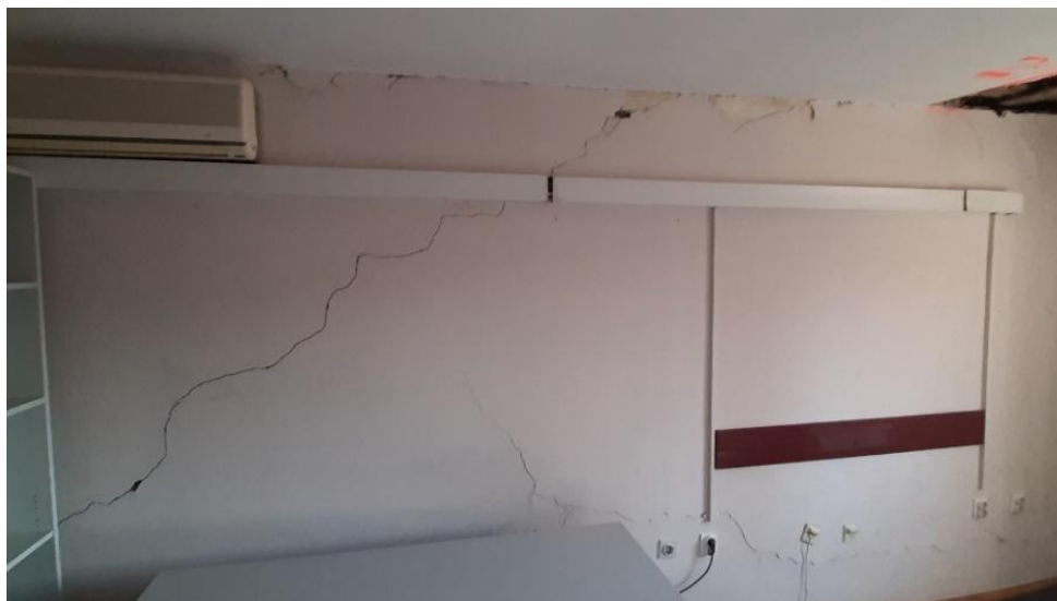
Slika 6.53 Pukotine na pregradnom zidu potkrovlja
